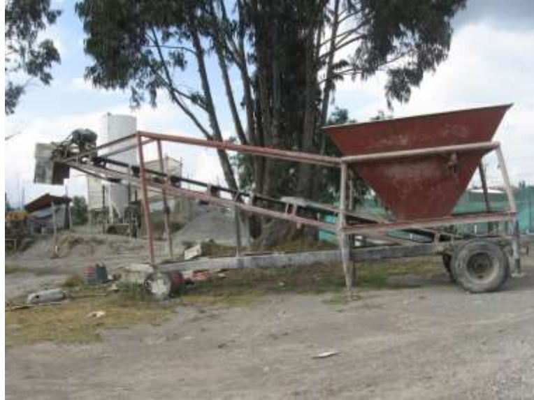
Vista de la planta Hormigonera Napo
