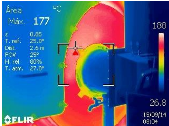
Figura 3.1 Imagen termográfica de la caldera YB701C
