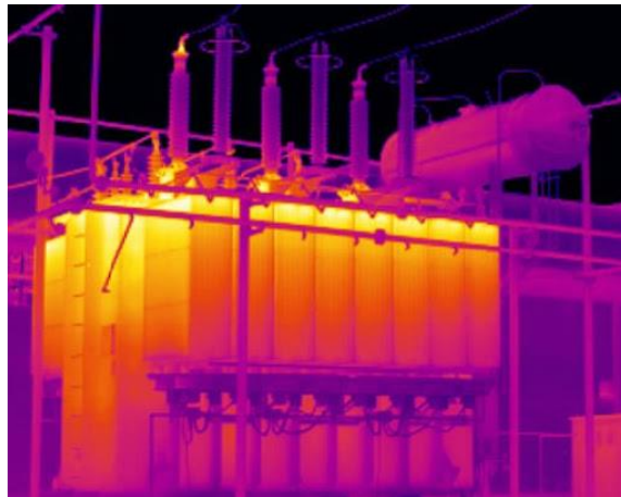
Figura 3. Fotografía termográfica de un transformador [10].
