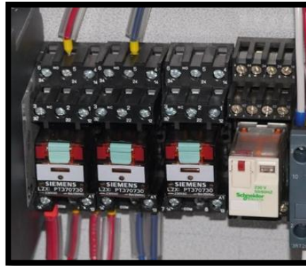
Figura 31. Relés de protección
