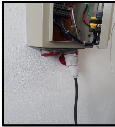
Figura 2 Energización del modulo
