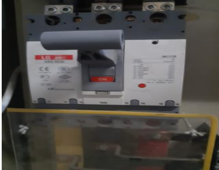
Figura C.3. Interruptor térmico principal de 800 A
