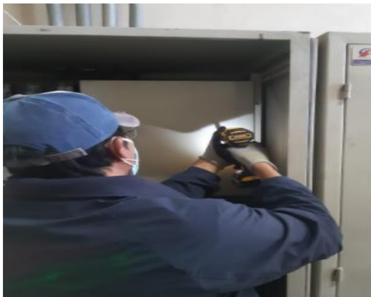
Figura E.2. Colocación de la caja de revisión en el tablero eléctrico
