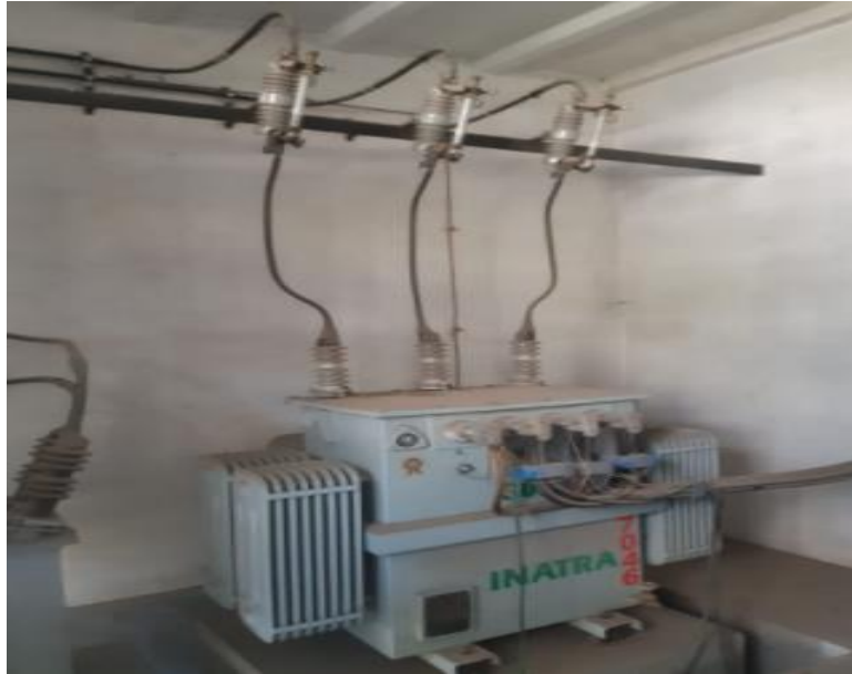
Figura C.1. Transformador de servicio de 300 kVA
