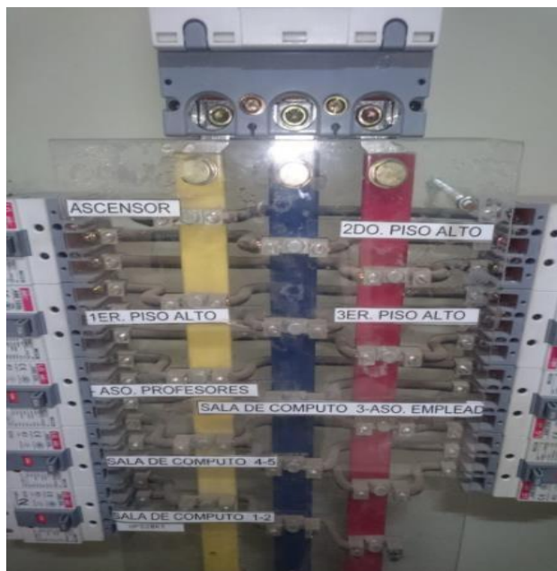
Figura 21. Tablero de distribución principal BLOQUE B.
