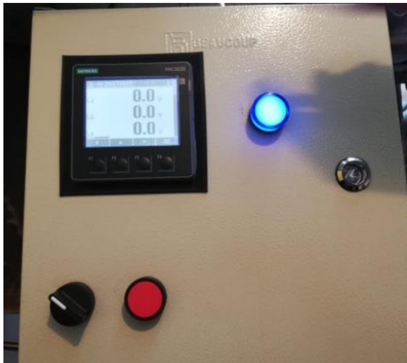
Fotografías. Tablero finalizado.
