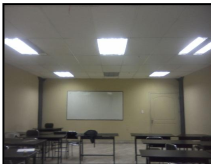
Figura N° 14 Situación actual de iluminación en aulas Fuente: Bermeo Christian - Granda Luis
