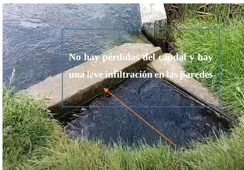
Fotografía 4: No hay pérdidas del caudal y hay una leve infiltración en las paredes en la caja de recolección
