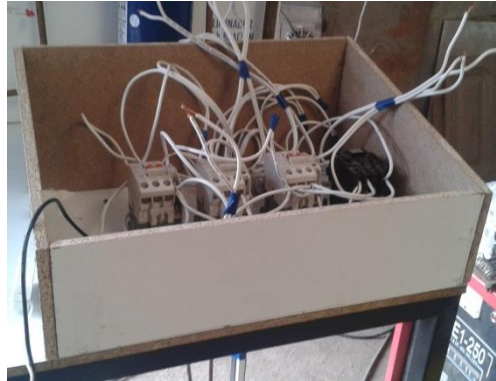
Figura 3.20 Ubicación del tablero de control
