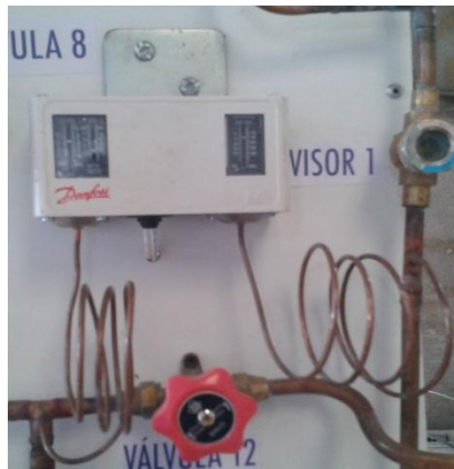
Figura 3.17 Ubicación de presostato de alta y baja
