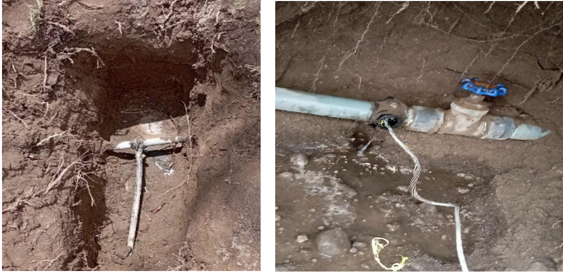
Figura 19 Estado de las tuberías según vida útil, identificación de pérdidas de fuga se agua
