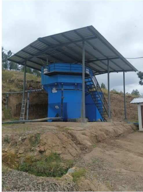
Figura. 11 Estación de recepción y distribución de agua La Victoria.
