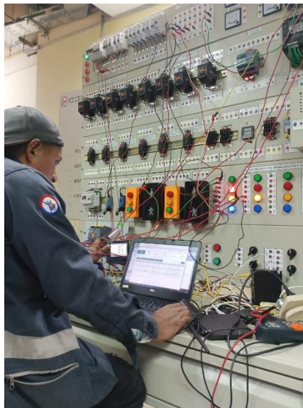
Figura. 38 Maniobras de la simulación estación de Bombeo.
