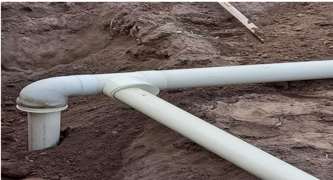
Figura A. 2.1. Ducto recolector de agua
