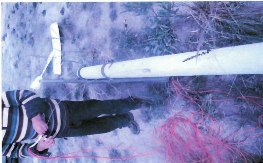
Gráfico 29. Poste de hormigón de 9 metros más el acople de acero G40
