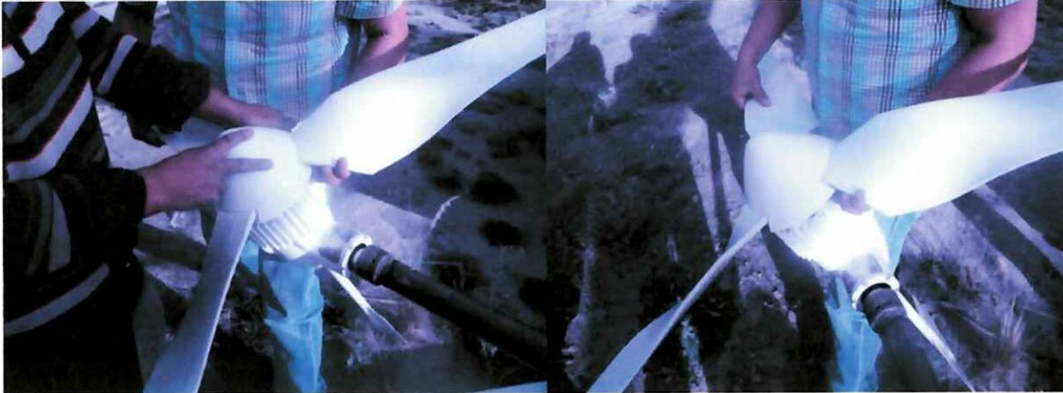
Gráfico 34. Colocación de la parte Cónica del Aerogenerador
