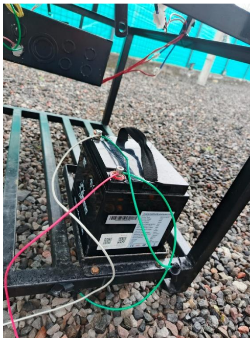
Figura 40. Conexión de la batería de Ion- Litio para la carga
