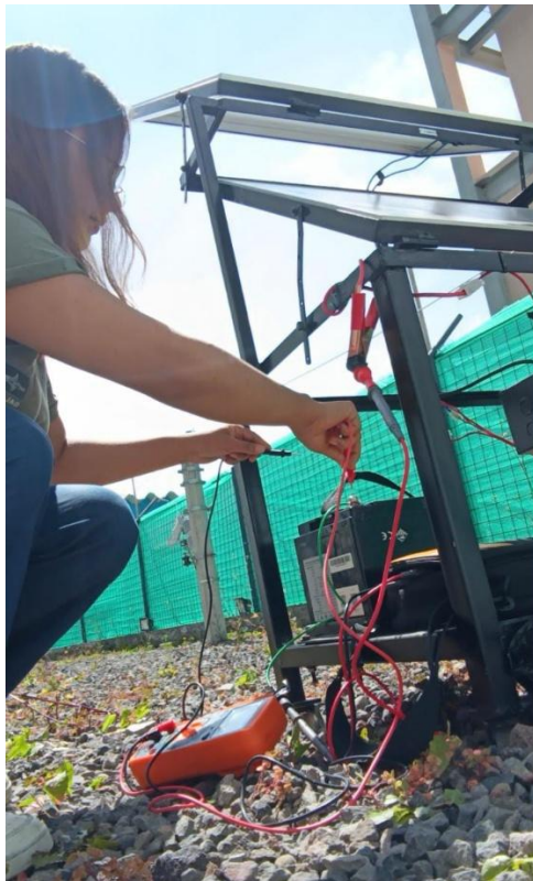
Figura 42. Medición del voltaje en los bornes de la batería
