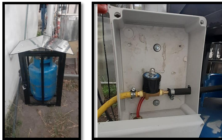
Figura 4.22. Ubicación del cilindro de gas y electroválvula
