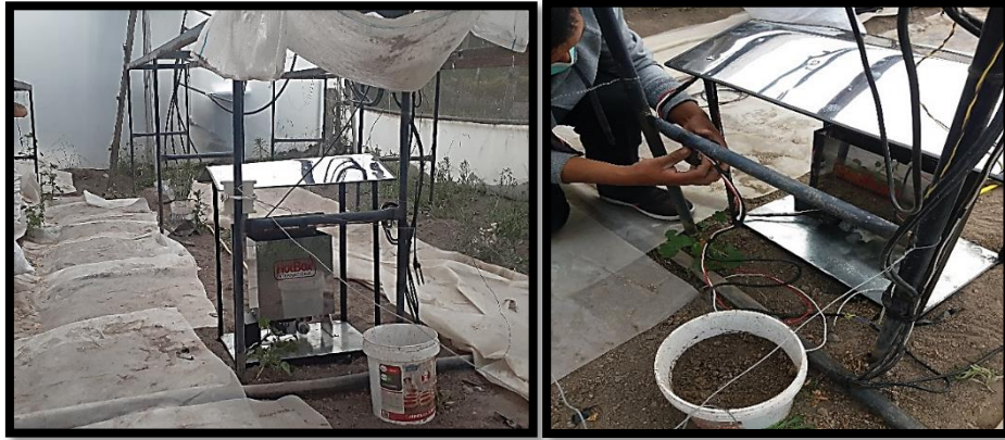
Figura 4.21. Ubicación del Generador de CO 2
