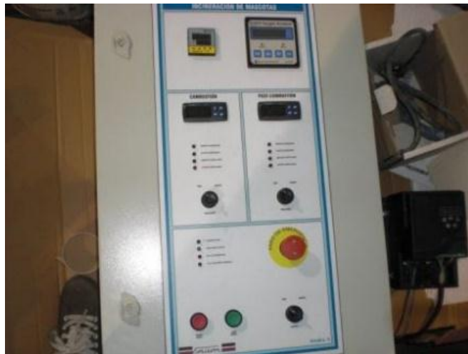
FIGURA 4.2 Tablero de control del evaporador Fuente: (Emison, 2016)
