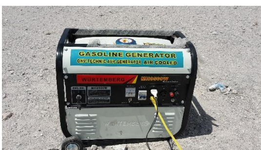
FIGURA 2.6 Generador eléctrico Gutemberg Fuente: Edwin Daniel Albán Castellanos
