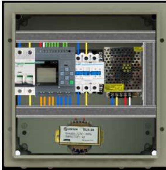
Figura 4-7: Conexiones internas tablero de control
