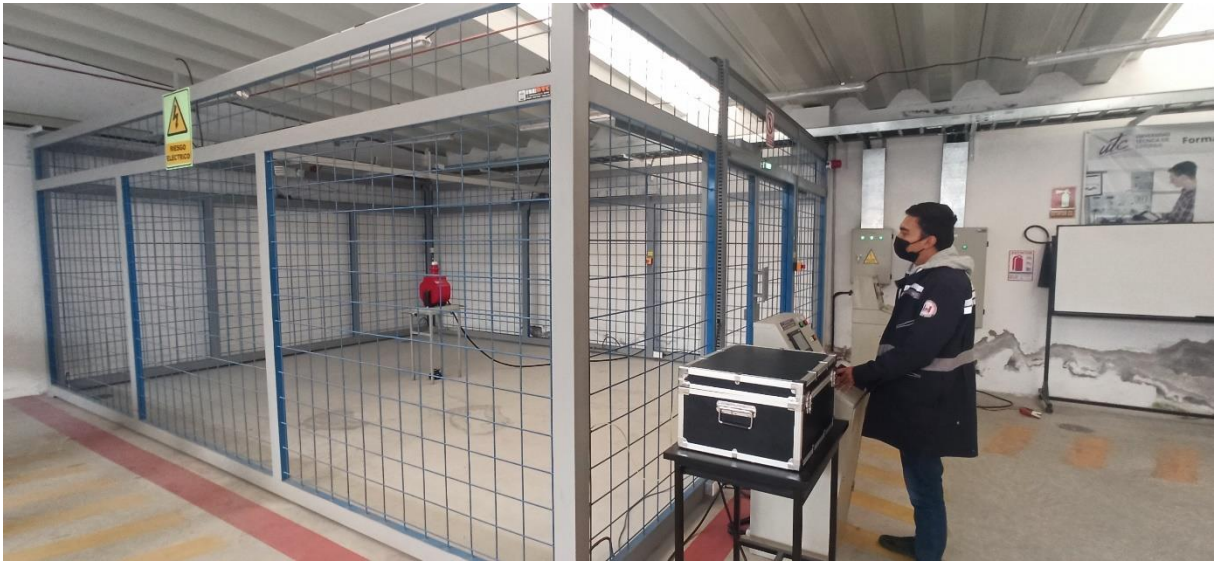
Figura F.1. Pruebas de operación del sistema de control
