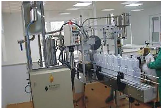
Figura 3.4. Automatización fija industrial [19].
