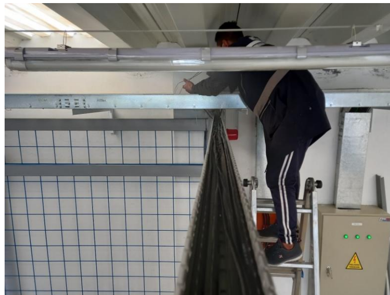
Figura E.8. Cableado del sistema de control de la Jaula de Faraday.
