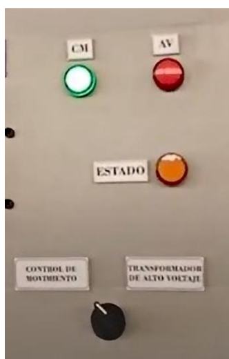
Figura 5.28. Luces piloto del tablero de control.
