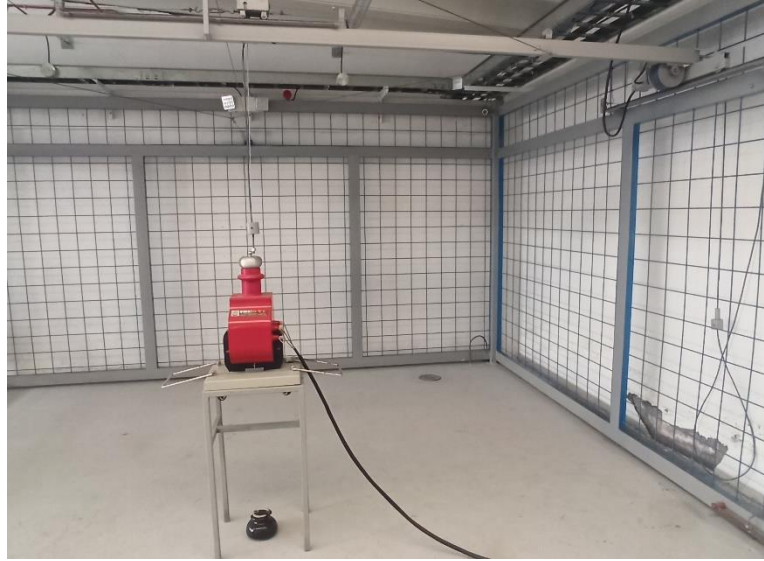
Figura F.5. Pruebas de disrupción dieléctrica mediante el transformador de Alto Voltaje, con un aislador tipo pin ANSI 55-5.
