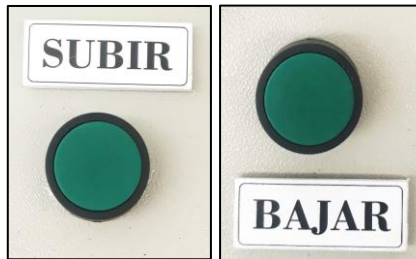
Figura 6. Pulsadores para el control del desplazamiento vertical.
