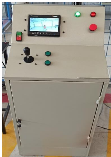
Figura 5.35. Tablero de control terminado.
