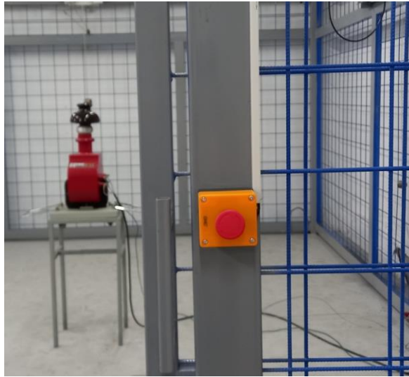
Figura E.12. Instalación de paros de emergencia.
