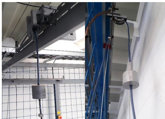
Figura 5.41. Cable de tierra empleado en el eje y
