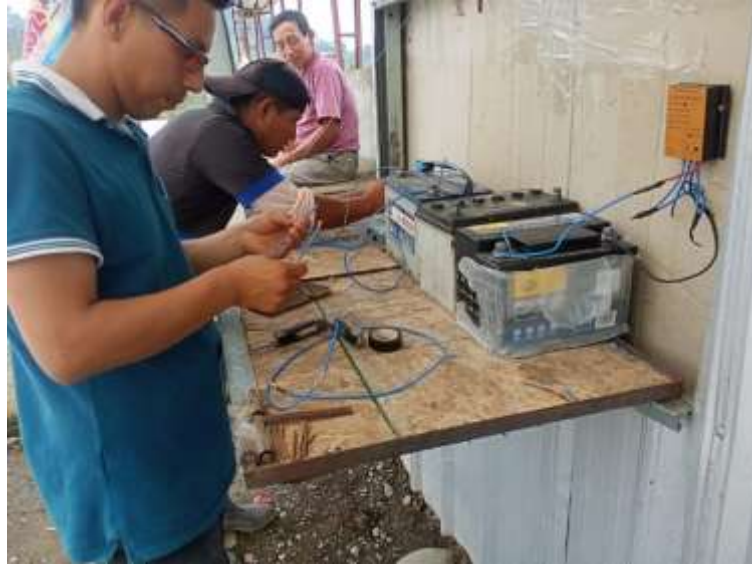
Figura 23 Colocación del regulador de carga eólico y ubicación de las baterías
