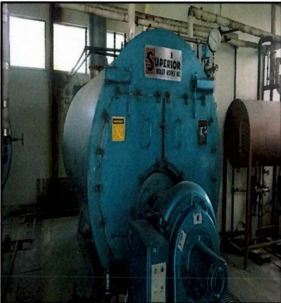
Desc.- Caldero en funcionamiento
