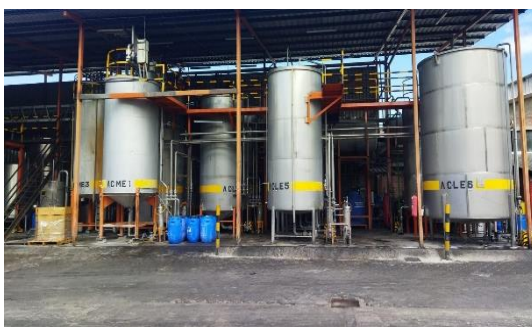
Figura 4.13: Sección de tanques para preparación de aceite.
