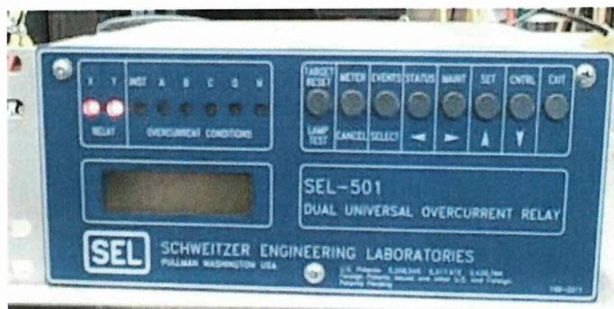
Figura No. 3.10 Relé de protección
