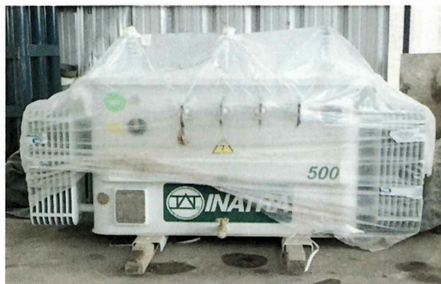
Figura No. 3.3 Transformador de 500 KVA
