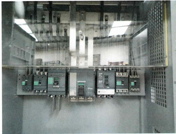
Figura No. 3.15 Interruptores en el Tablero
