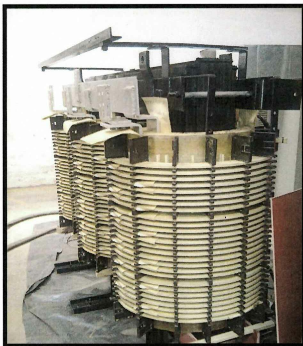
Figura No. 2.4 Transformador (seco)
