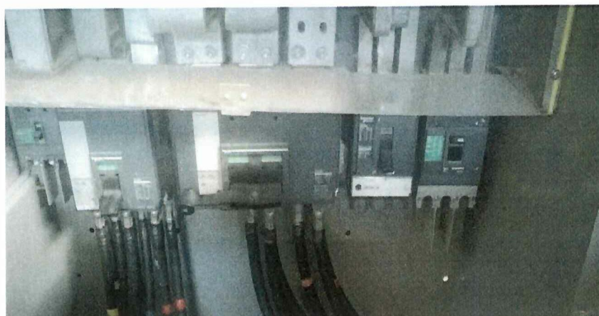
Figura No. 3.14 Distribución de los Interruptores en el tablero de 220 V
