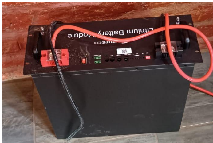
Figura 18 Batería de Ion-litio de 100 Ah
