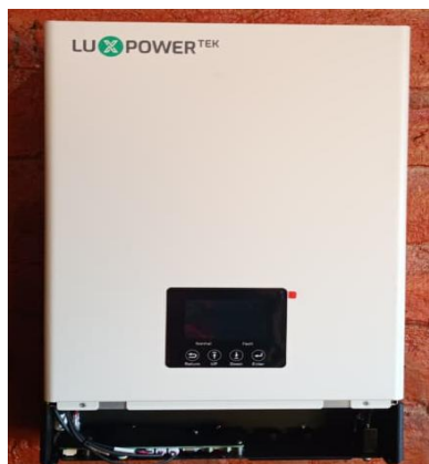
Figura 2 Regulador del sistema fotovoltaico
