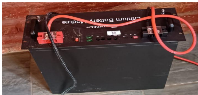
Figura 3 Batería del sistema
