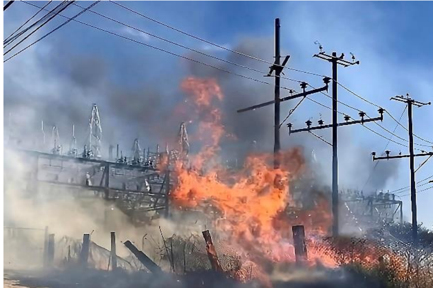
Figura 3.3 Humo afectando a las líneas e infraestructura de subestación [21].
