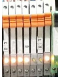
Figura 3. 18. Relés de interface implementado en el tablero de control.
