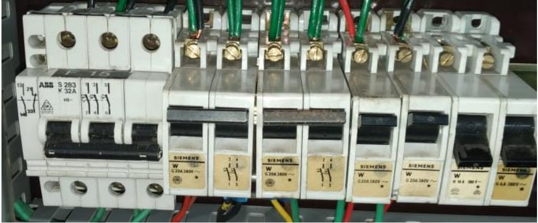
Figura IV. 9. Conexión de interruptores termo magnéticos.
