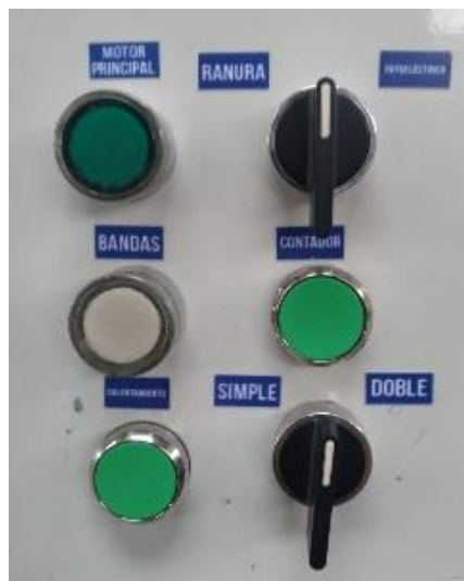
Figura 5. 6. Tablero de control principal.
