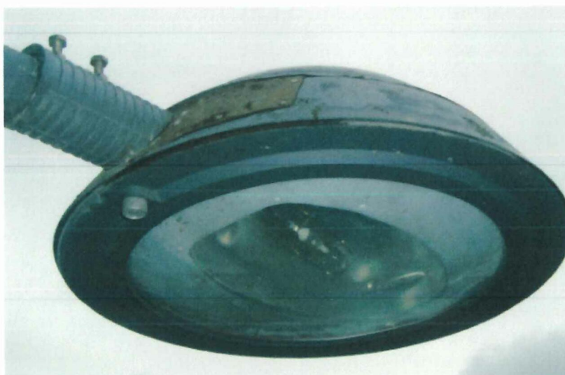
FIGURA 32: Luminaria del Alumbrado Público.
