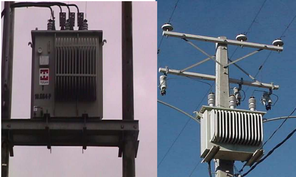
Fig 4 Transformador de distribución tipo plataforma Fig 5 Transformador de distribución tipo poste
