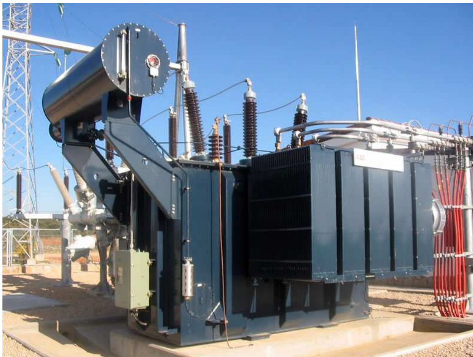
Fig.2 Transformador de Potencia
