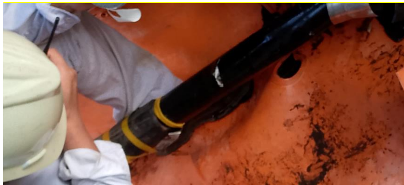
Figura 7.Estado del conductor posterior a la prueba hi-pot (L2 fase C).
