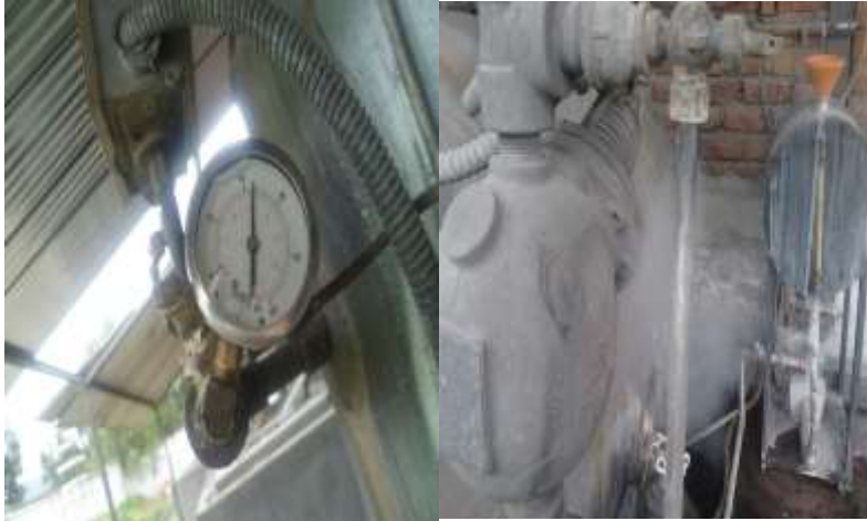
Ilustración 24: Medición de pérdidas de fugas de vapor
