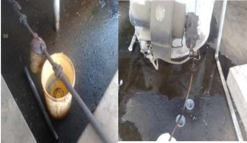
Ilustración 23: Medición de pérdidas de combustible
