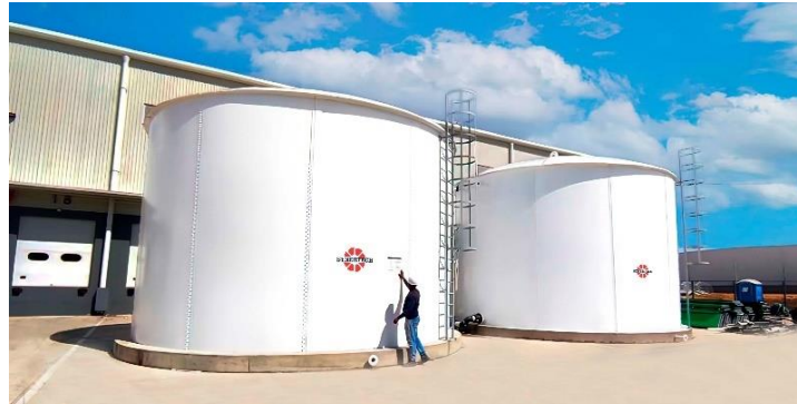
Figura 3. 3 Tanque de almacenamiento en el piso [19]
