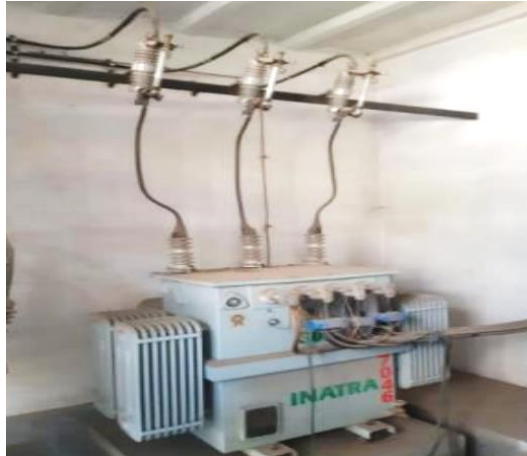
Figura 4.3 Transformador de 300 kVA
