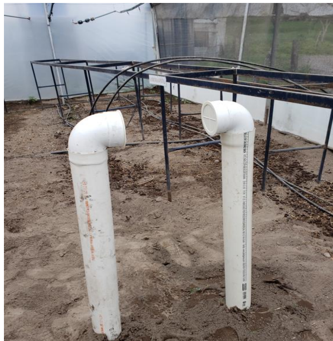
Figura 23. Tuberías enterradas del invernadero
