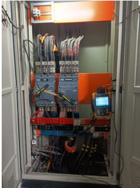
Figura 4.8. Instalación del analizador de red en la Empresa
