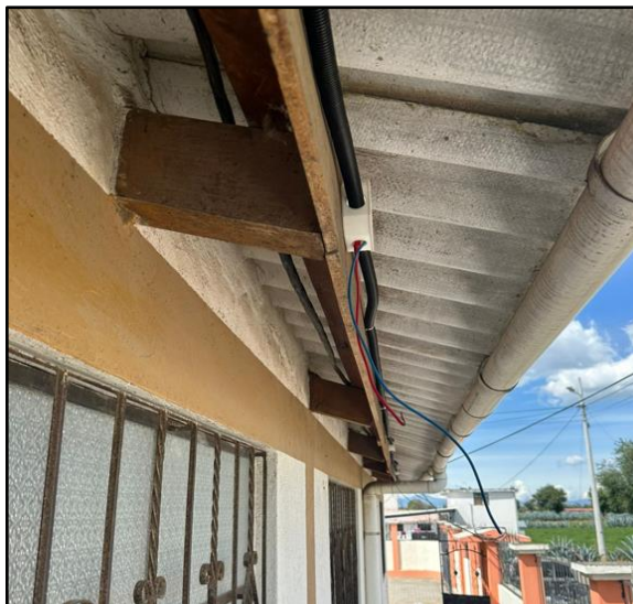
Figura 76. Instalación eléctrica de las luminarias externas.
