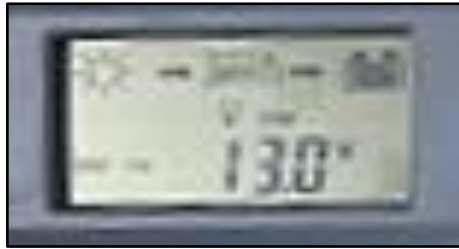
Figura 118. Visualización de carga y voltaje del banco de baterías.
