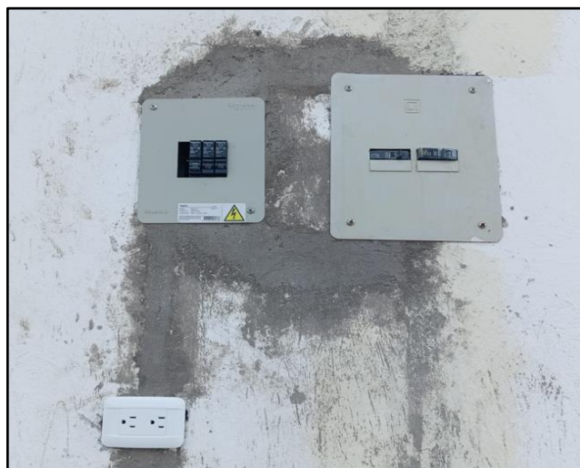
Figura 80. Tableros de distribución red eléctrica y sistema solar fotovoltaico Off Grid.
