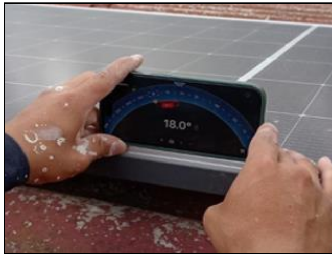
Figura 43. Inclinación de los módulos fotovoltaicos.
