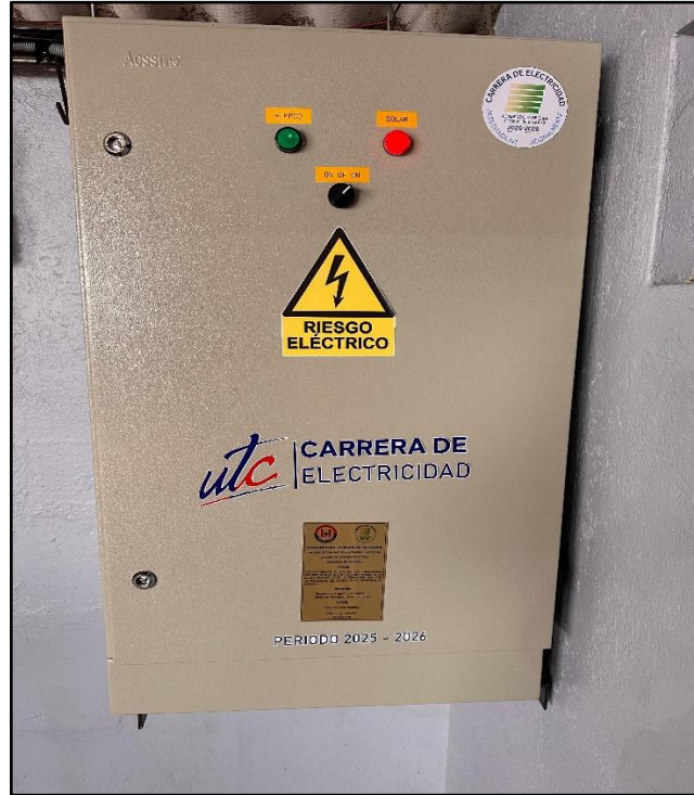
Figura A. Tablero de transferencia del sistema fotovoltaico Off Grid.
