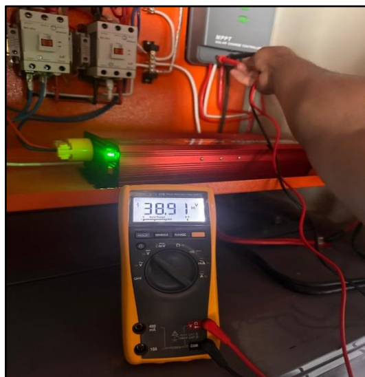
Figura 117. Nivel de voltaje desde los paneles hacia el controlador.
