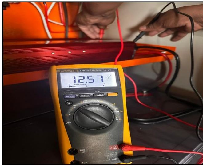
Figura 116. Nivel de voltaje desde la batería hacia el inversor.
