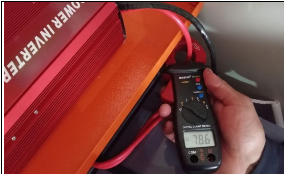
Figura 119. Corriente real de descarga de todo el sistema en operación.
