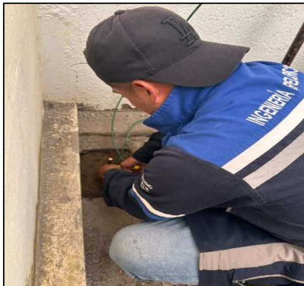
Figura 85. Instalación de la puesta a tierra al tablero de transferencia Off Grid,
