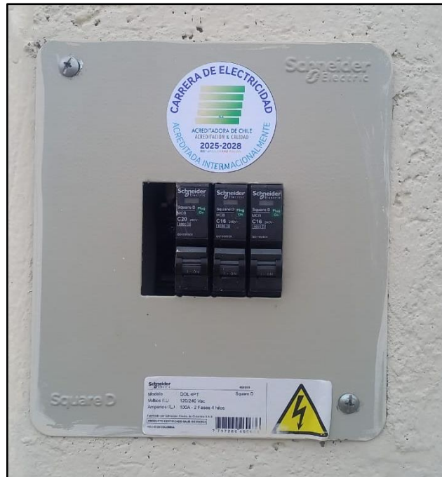
Figura E. Tablero de distribución del sistema fotovoltaico Off Grid.
