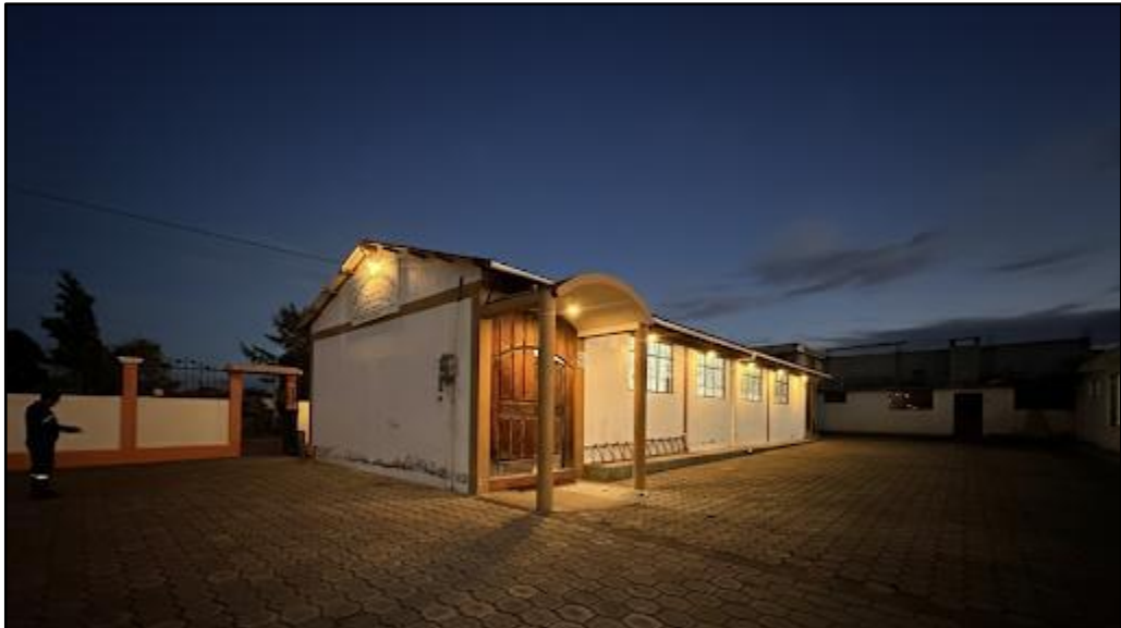
Figura F. Sistema de iluminación externa de la iglesia en funcionamiento.
