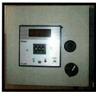
FIGURA 3. 12 TABLERO DE CONTROL DE TEMPERATURA
