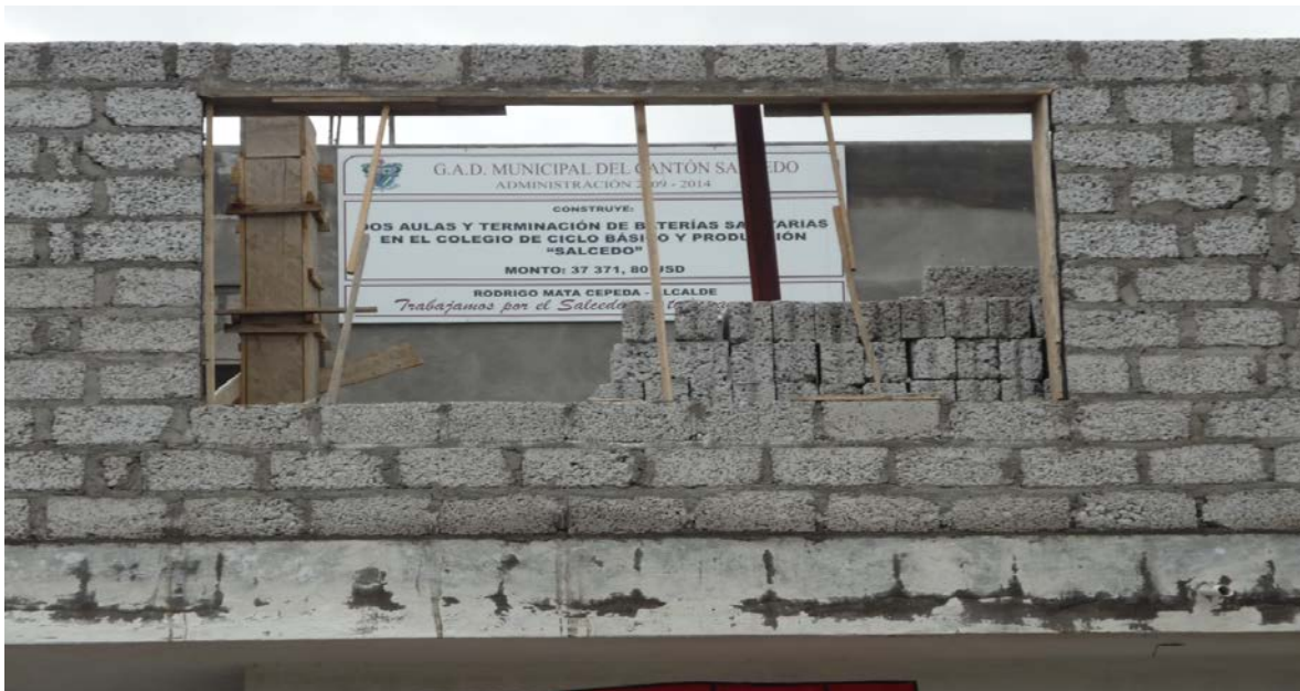
9. Aulas en construcción por parte del municipio para el colegio Fiscal de Ciclo Básico Popular y de Producción Salcedo.
