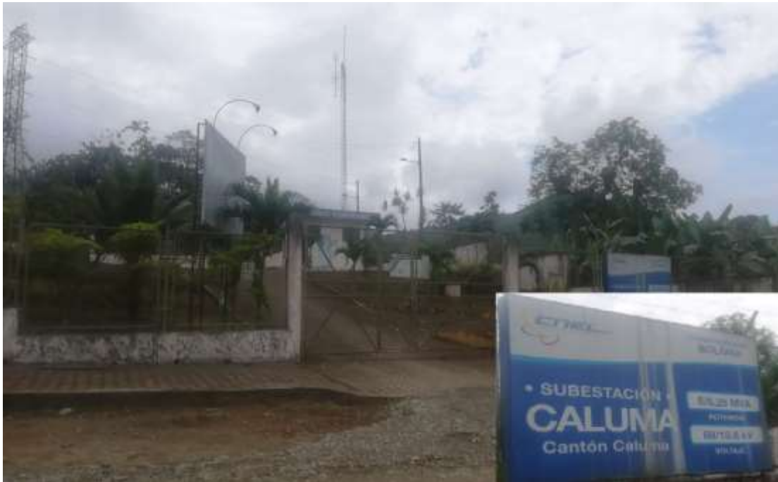
Ilustración 1. Subestación Caluma 69/13,8 kV
