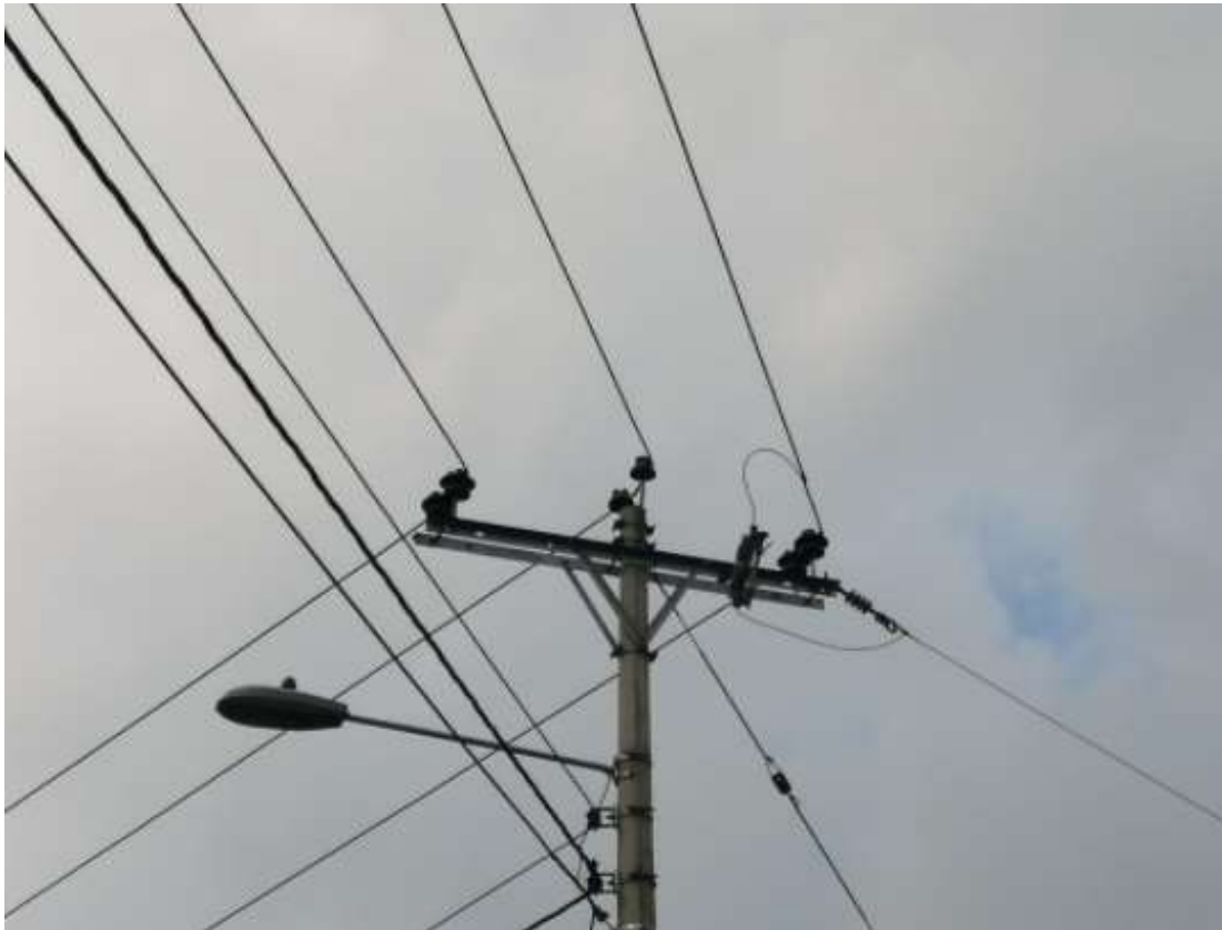
Ilustración 7. Levantamiento de vanos red trifásica del alimentador Pita
