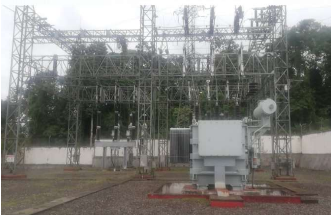
Ilustración 2. Patio Subestación Caluma 69/13,8 kV
