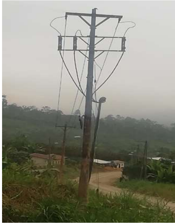
Ilustración 4. Salida del alimentador Pita - 13,8 kV
