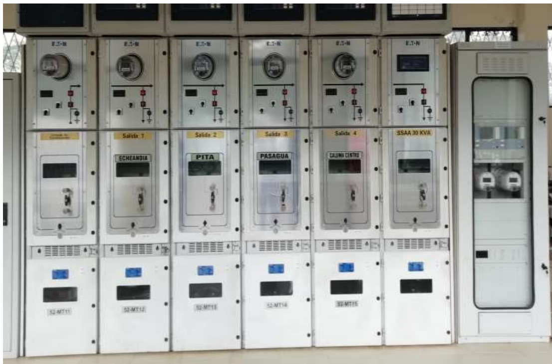
Ilustración 4. Tablero de distribución de medio voltaje 13,8 kV de la Subestación Caluma
