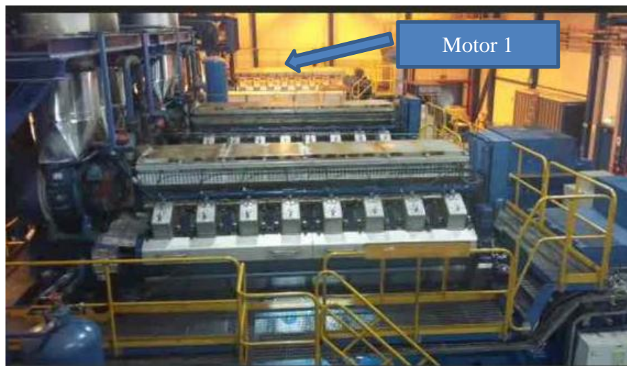
Figura 2.2 Planta de Generación GD Petroamazonas EP Bloque 12
