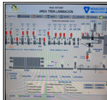
Figura 1.20 Control H.M.I Fuente: Sala de Control T1
