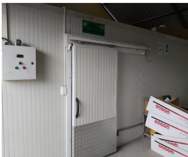
Imagen 8.10: Rehidratación y cuarto frío
