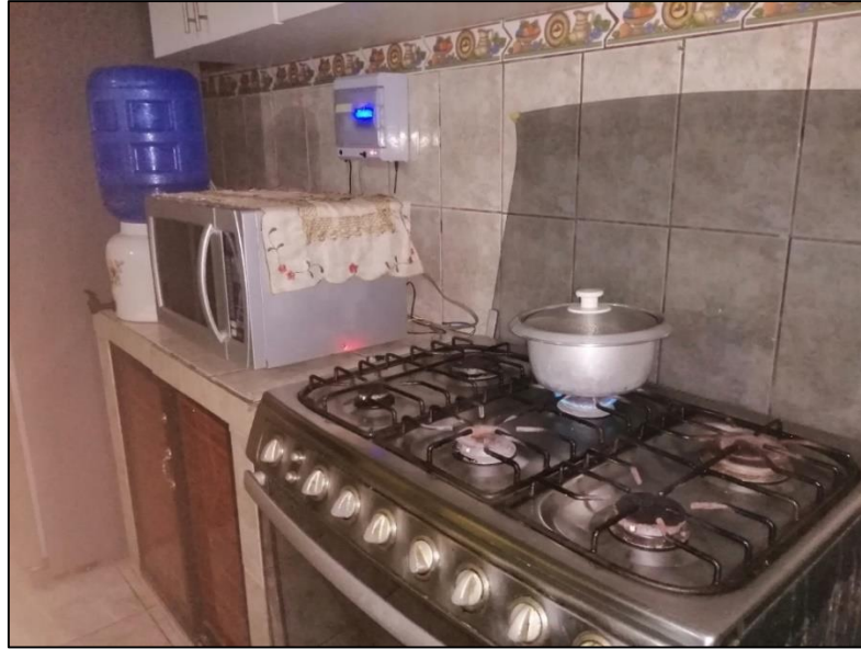
Figura 32: Sistema en funcionamiento
