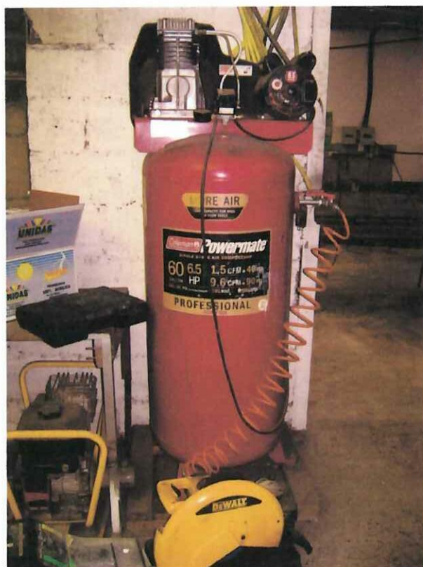
FOTOGRAFÍA No. 03.- EQUIPO COMPRESOR
