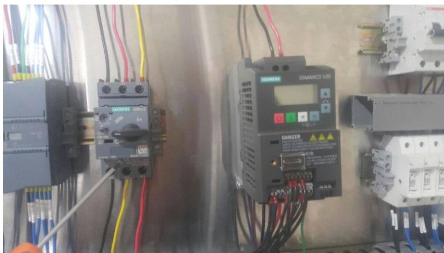
Anexo 5. Variador de frecuencia
