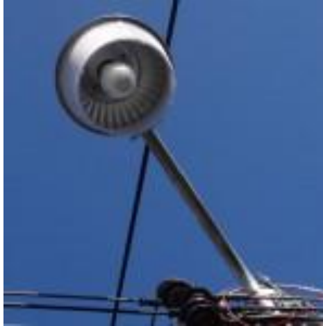
Fig. 2.2. Luminaria de Vapor de Mercurio Alta Presión existente
