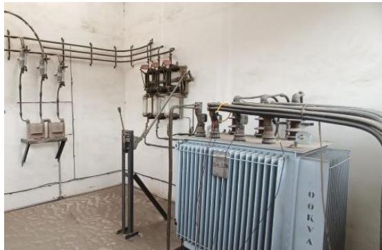
Figura 6. Transformador de 500 kVA
