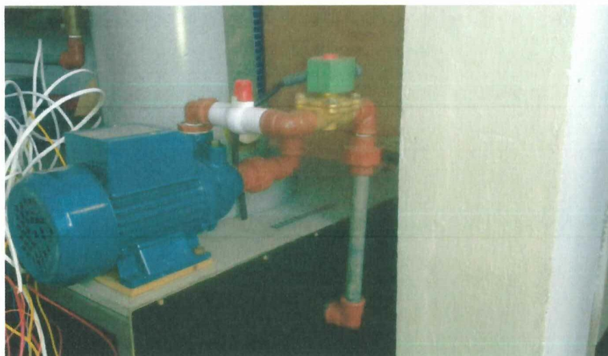
Bomba #2 activa la electroválvula que me permite el vaciado del tanque.
