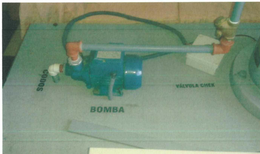
Bomba #1 llenado del tanque
