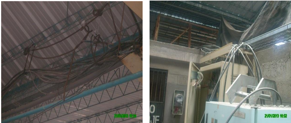
Grafico N° 3.3: Conductores eléctricos PROMPELL S.A.
