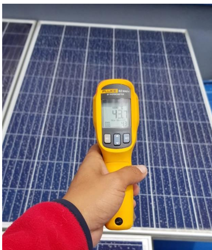
Figura V.2: Medición de la temperatura del panel fotovoltaico N° 2.
