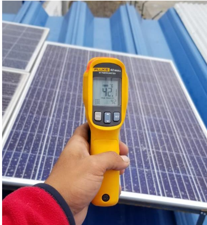
Figura V.3: Medición de la temperatura del panel fotovoltaico N° 3.
