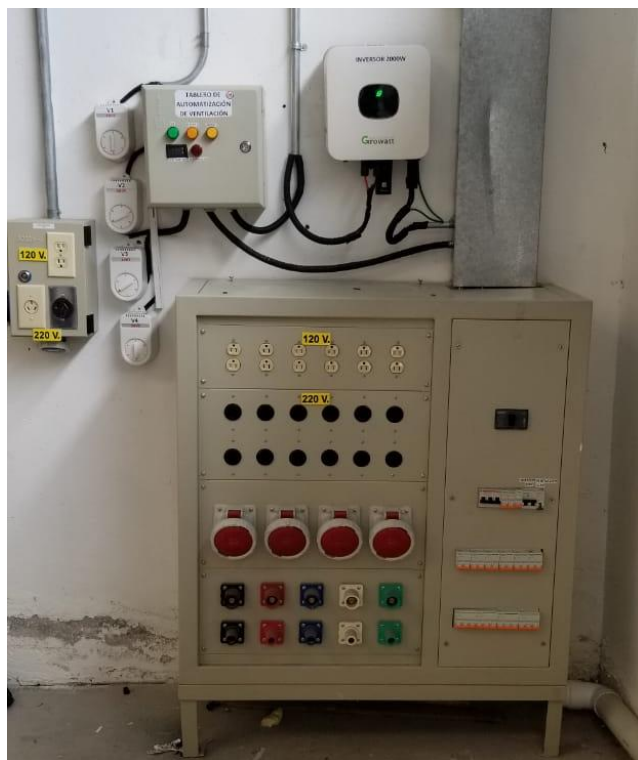
Figura X.1: Inversor ON GRID, tablero de control y tablero de distribución.
