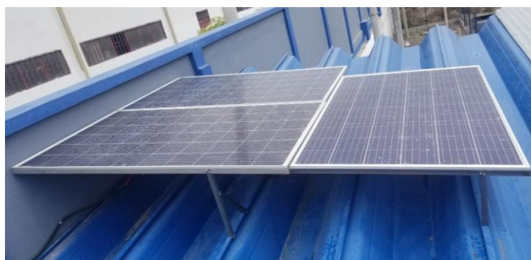
Figura 38. Paneles fotovoltaicos instalados en el techo del laboratorio de alto voltaje.
