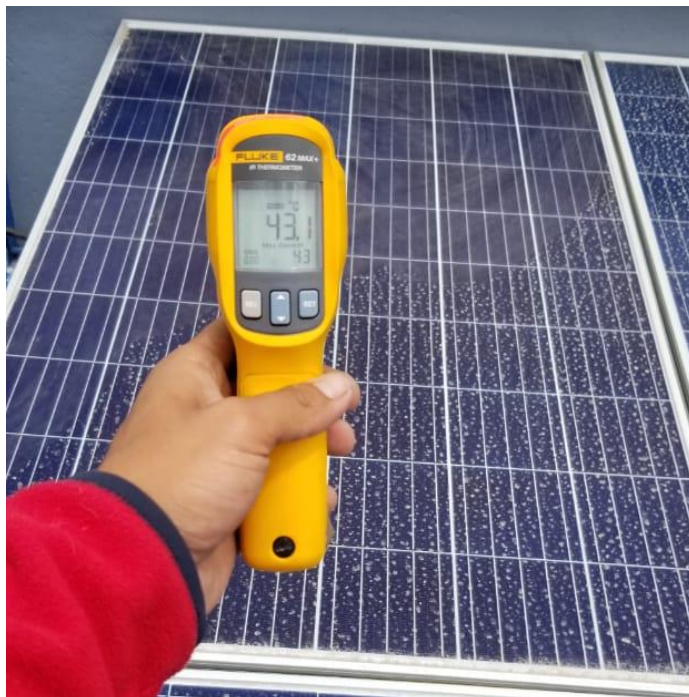
Figura V.1: Medición de la temperatura del panel fotovoltaico N° 1.
