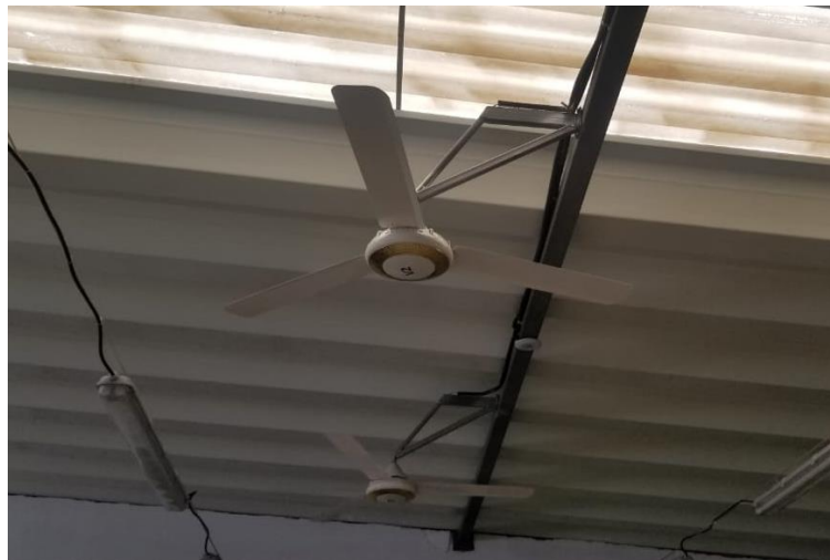
Figura 50. Ventiladores 1 y 2 con su estructura de refuerzo.
