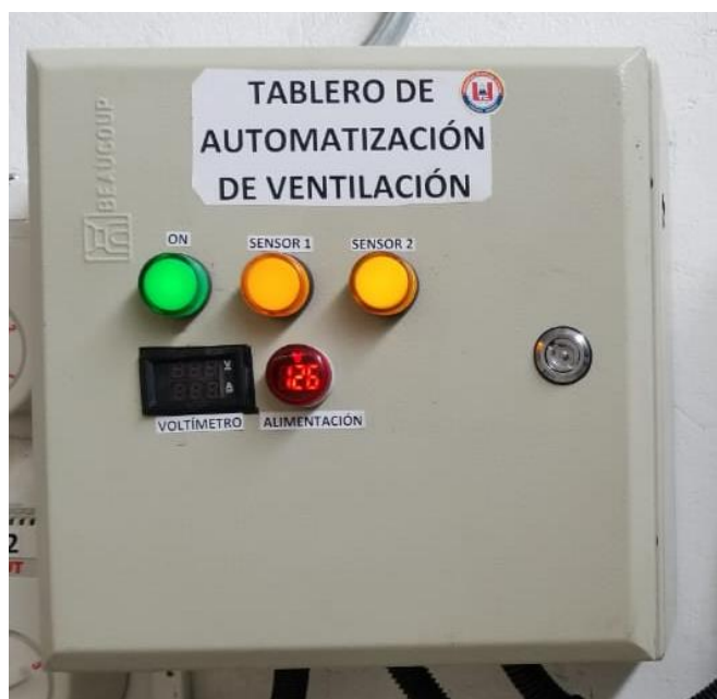
Figura 69. Luces piloto y voltímetro del tablero de control.
