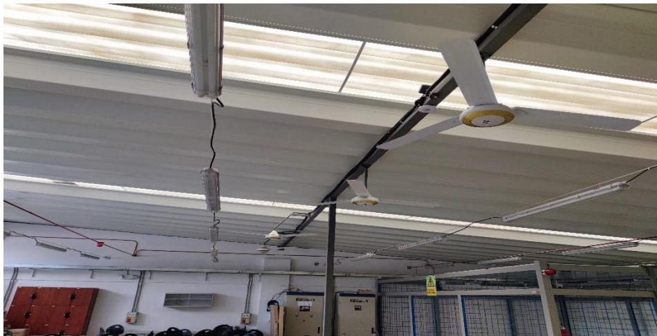
Figura 49. Ventiladores implementados en el laboratorio de alto voltaje.
