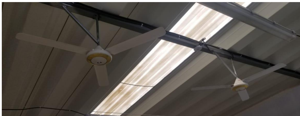
Figura 51. Ventiladores 3 y 4 con su estructura de refuerzo.
