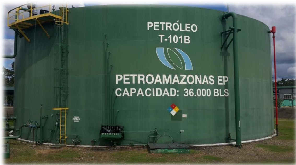
Figura 2.17. Tanque de almacenamiento de Crudo
