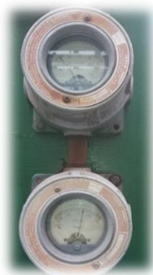
Figura 4.4. Voltaje y amperaje transformador del deshidratador V-107B lado derecho.
