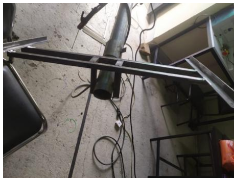
Figura 4.6 Estructura para el panel solar
